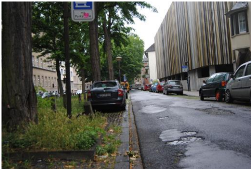
Abb. 35 marode Fahrbahn Südallee
