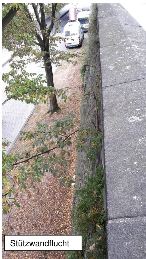
Mauerwerksausbrüche und Bewuchs
