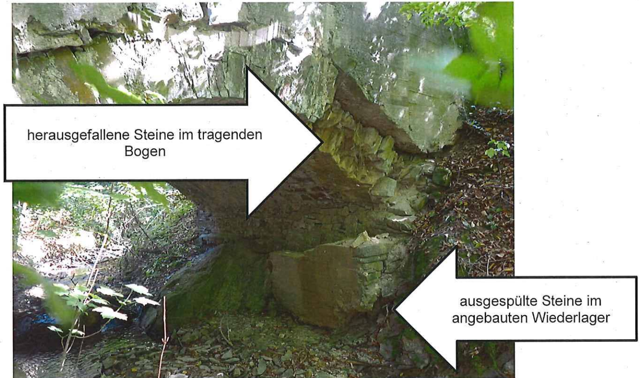
Bild 2 Bogen mit fehlenden Steinen im tragenden Bogen
