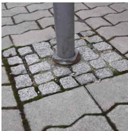
Bild 49: Standrohr in Bodenhülse.
