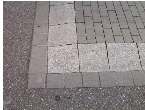
Bild 26: Aufpflasterungen (Läufer innen fehlt)
