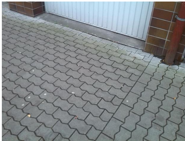
Bild 9: Gedrehtes Pflaster in einer Zufahrt
