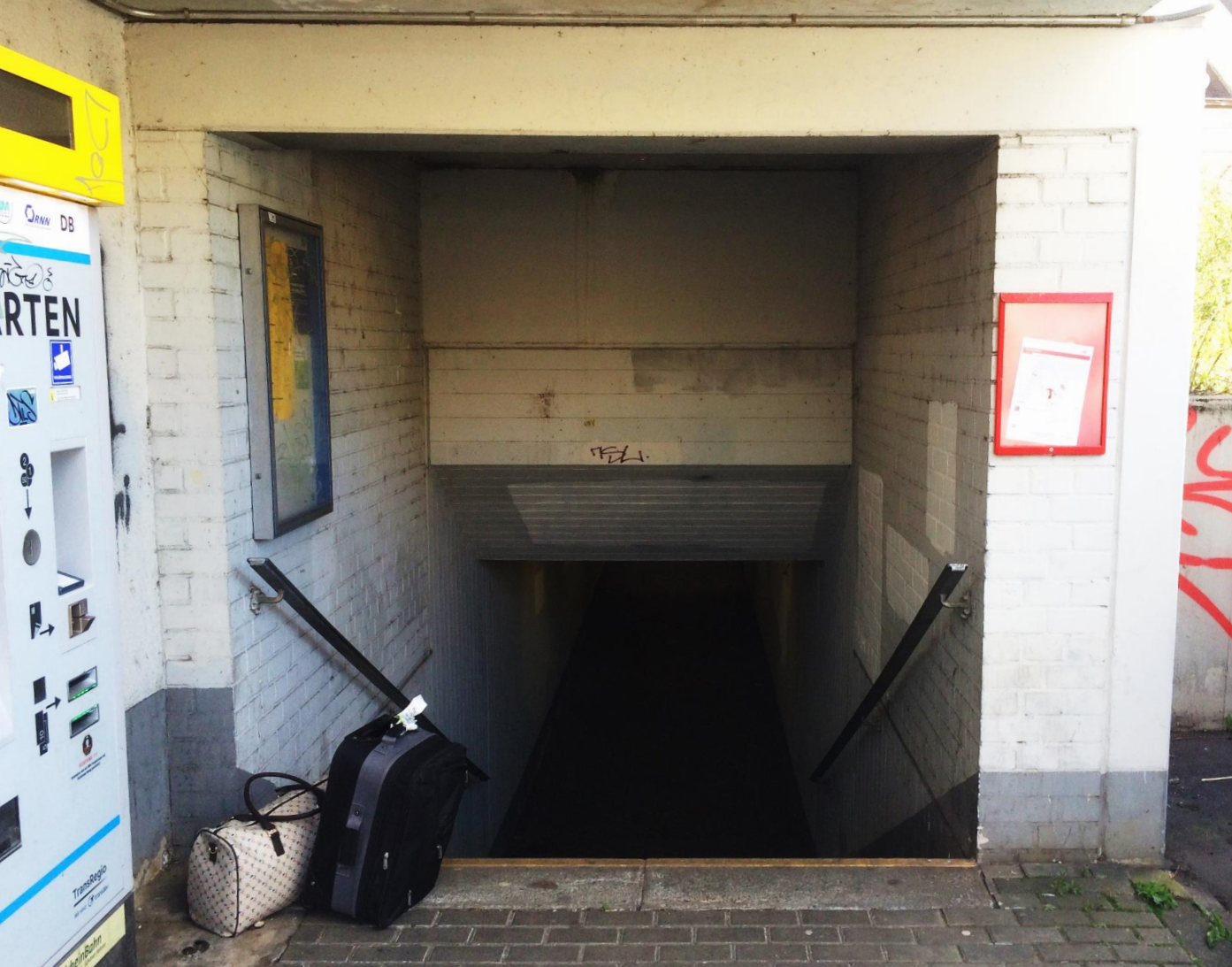
Fehlende Barrierefreiheit der Personenunterführung (PU)
