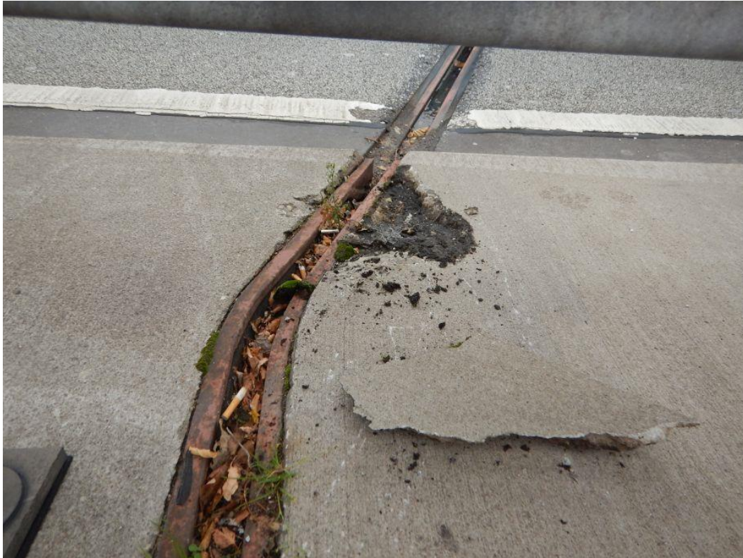
Abb. 3 schadhafte Dehnfuge Europabrücke stadteinwärts
