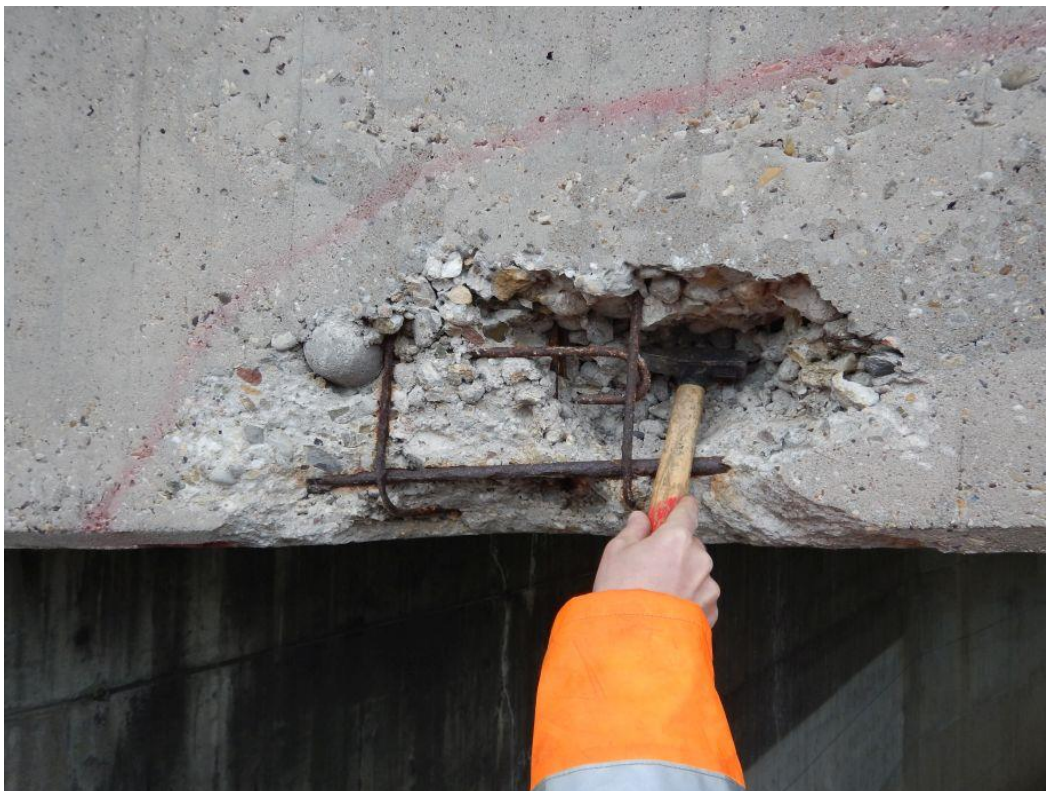
Abb. 2 Betonausbruchstellen Europabrücke stadteinwärts
