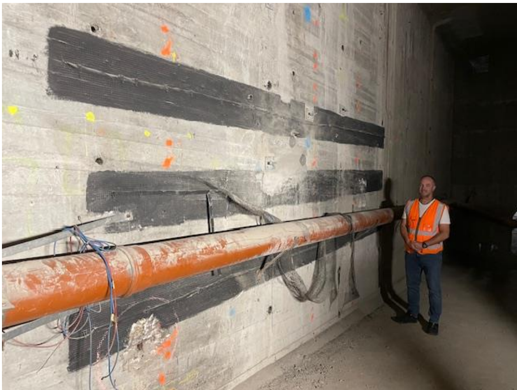
Abb. 4 gescheiterter Sanierungsversuch im Stegbereich Europabrücke stadteinwärts (Elektroosmose)
