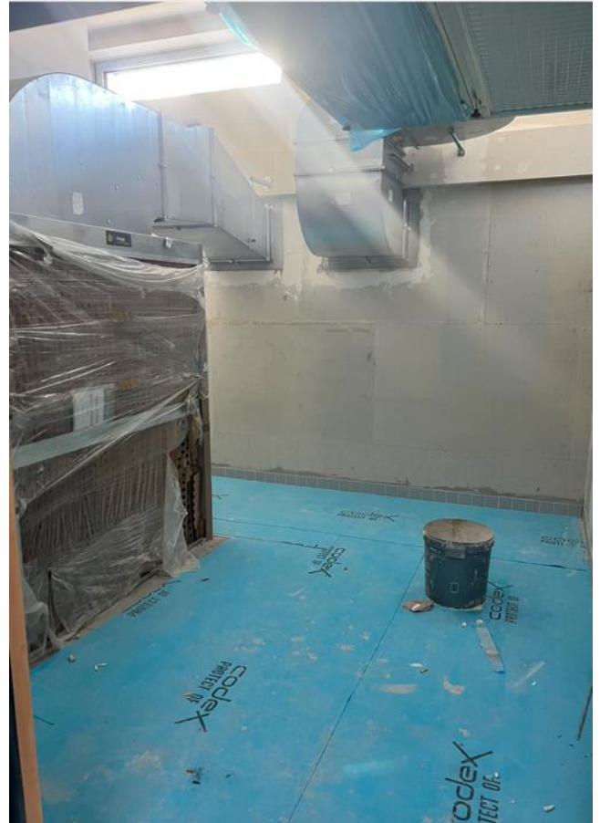
Lackierraum mit Spritzkabine
