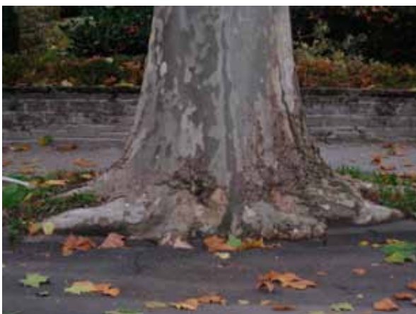
Baumstandort zu nah am Hochbord zerstört Nebenanlagen
